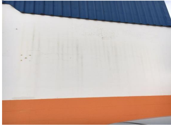
Figura 7 – Manchamento em coberturas metálicas
