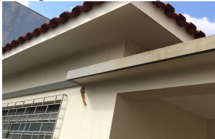
Figura 03 – Descolamento de argamassa
