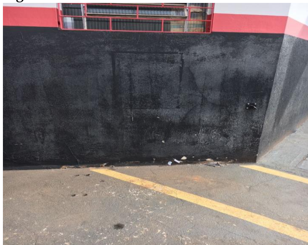
Figura 9 – Manchamento em revestimento à tinta
