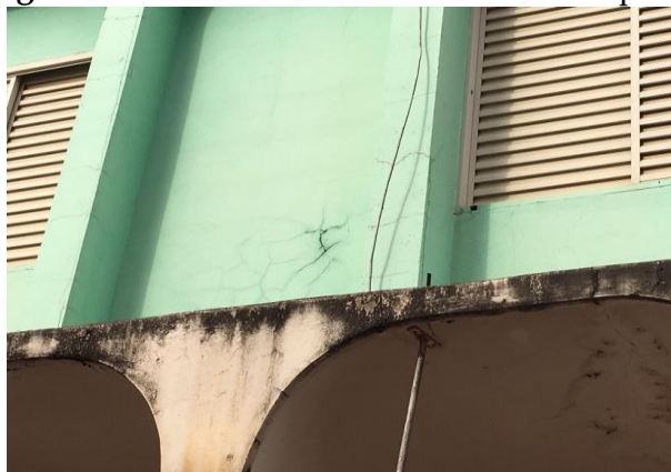
Figura 5 – Manchamento e fissuras em marquises
