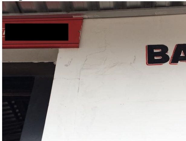
Figura 8 – Fissuras em coberturas metálicas
