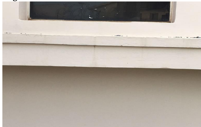
Figura 04 – Manchamento em coberturas cerâmicas
