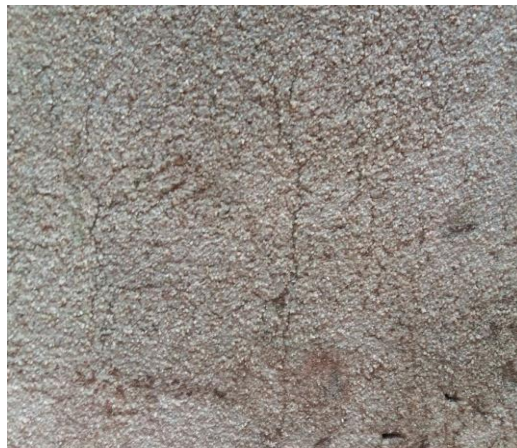
FIGURA 3. Fissura na argamassa com areia marinha
