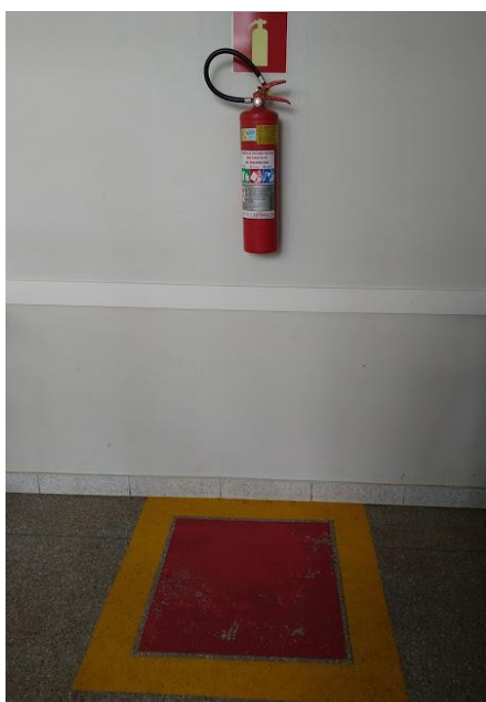
FIGURA 4. Extintor de incêndio (Rodrigues, 2017)
