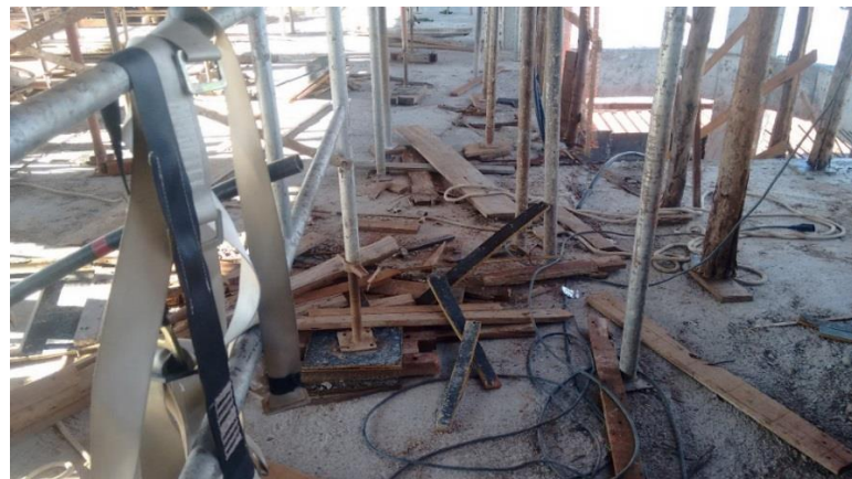
FIGURA 2. Material espalhado pelo canteiro de obras
