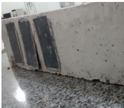
Figura 9. Desprendimento das placas de laminado de carbono após o rompimento
