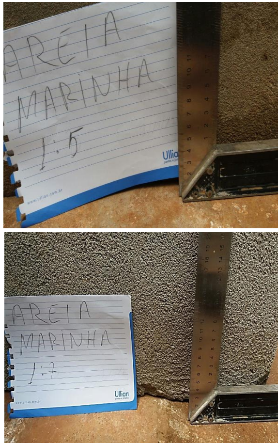
FIGURA 2. Altura de mancha por umidade
