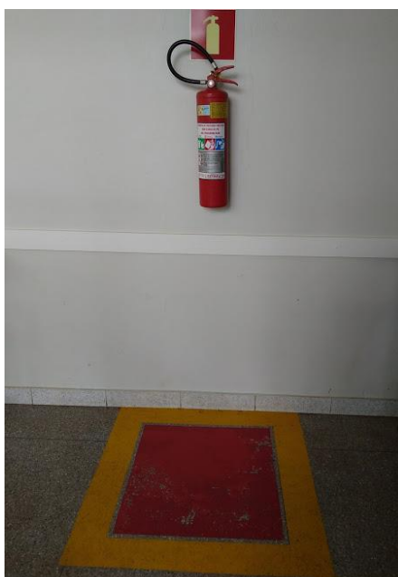
FIGURA 4. Extintor de incêndio (Rodrigues, 2017)
