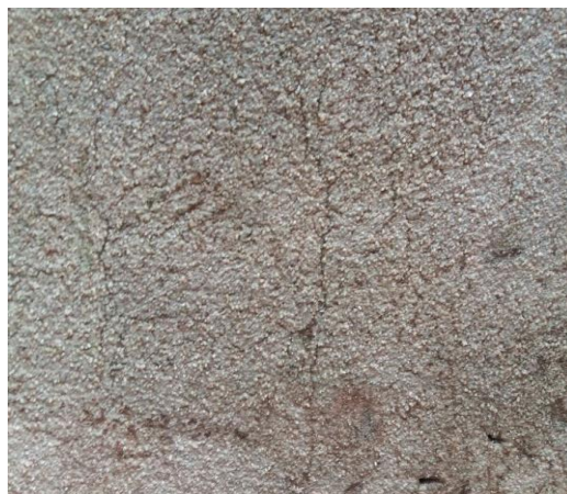
FIGURA 3. Fissura na argamassa com areia marinha
