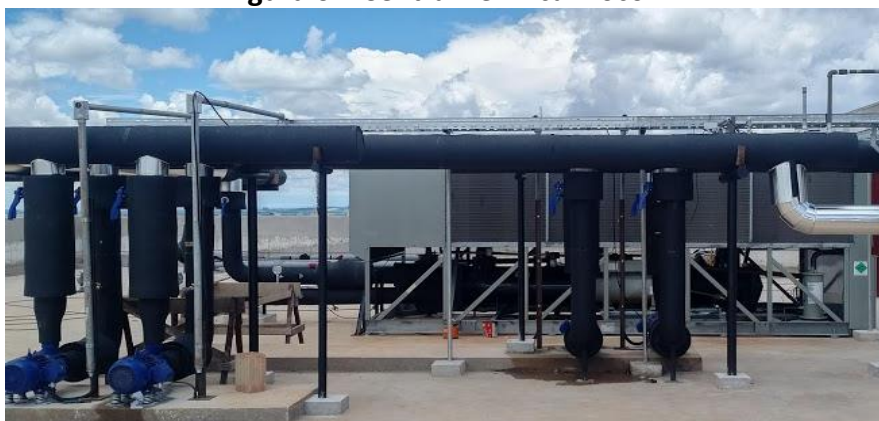
Figura 6 – Central Térmica Bloco B
